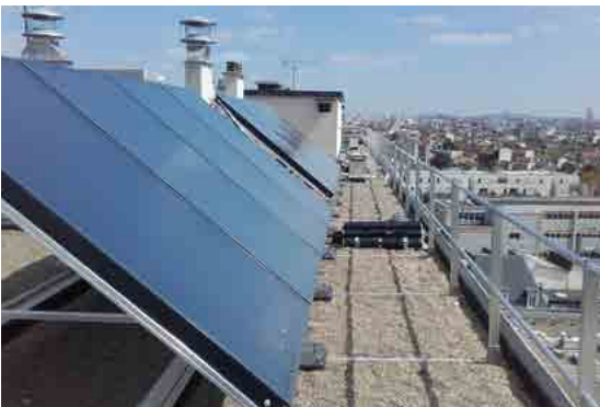
> Panneaux solaires - 91-97 boulevard de Valmy
