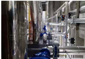
> Chaudière à condensation 45 rue J. Michelet
