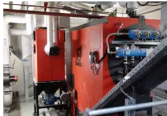
> Chaufferie biomasse 4 rue de l'Agriculture
