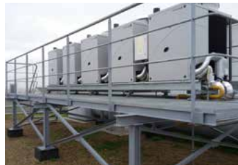
> Pompes à chaleur 7 avenue d'Orgemont
